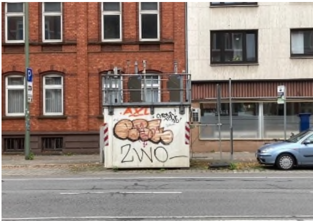
Abb. 5.93: DENI067 Osnabrück (OKVT) (Bildaufnahme August 2023)
